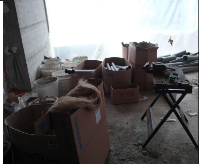
Nepripravljene okenske odprtine
