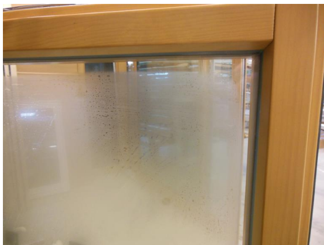
Izostanek kondenza na robovih stekla
