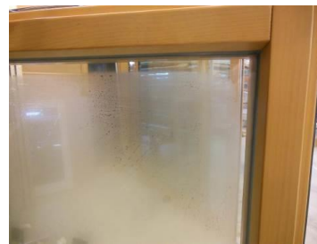
Abb. 62: Kondenswasser auf dem Außenglas
