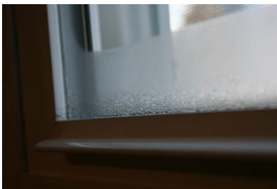
Abb. 61: Kondenswasser auf der Innenseite der Fensterscheibe
