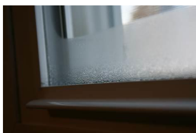
Immagine 61: Appannamento vetro interno
