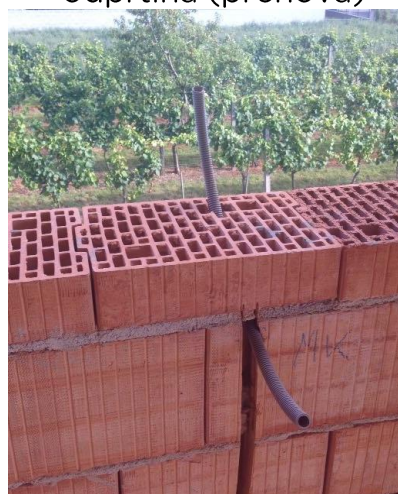
Nepravilno pripravljena okenska odprtina (novogradnja)
