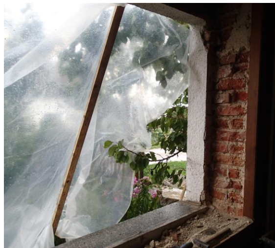
Nepravilno pripravljena okenska odprtina (prenova)
